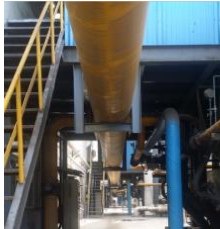
沼气输送管道
