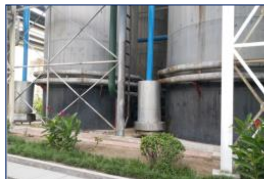
发酵罐排气管道末端消音器
