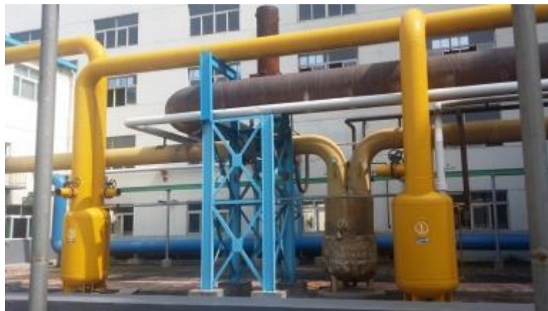
沼气隔离罐联络罐
